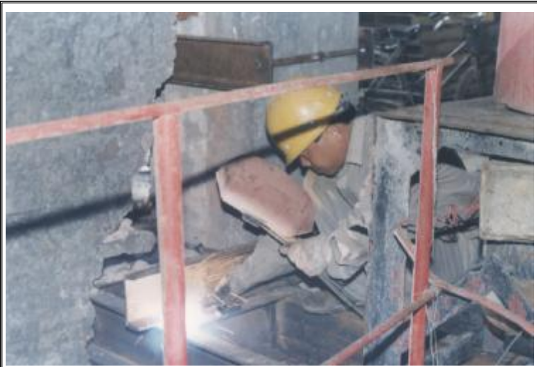
一切为生产着想,有设备故障能随喊随到及时抢修。图为检修人员在抢修分离机底座。(成玲、文、欧力摄)
