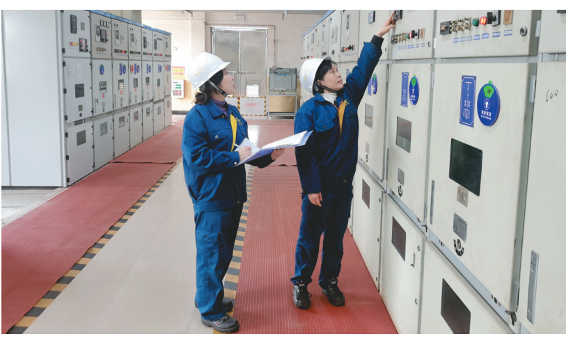
在铜冠冶化分公司动力保全中心110千伏变电站配电班,11名与“电”共舞的“铿锵玫瑰”在控制中心、配电机房、巡检线路上绽放着新时代女性的芳华,以“她”力量保障电网安全稳定运行和电力可靠供应。图为2月26日该分公司配电班在对电容器室工作状况进行巡检记录。 通讯员 胡永斌 刘文军 摄
