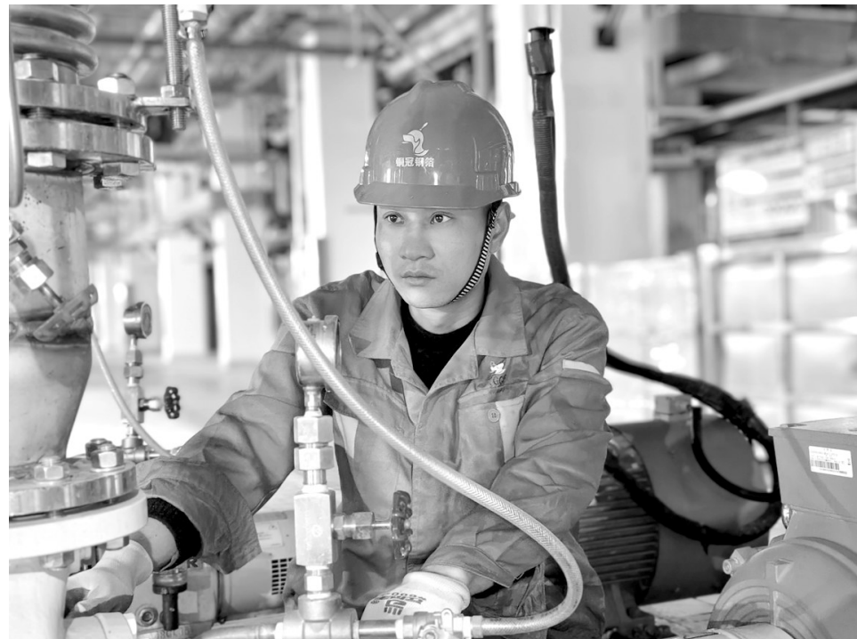
图为胡善杰正在点检高位槽泵压力和机封水情况。
