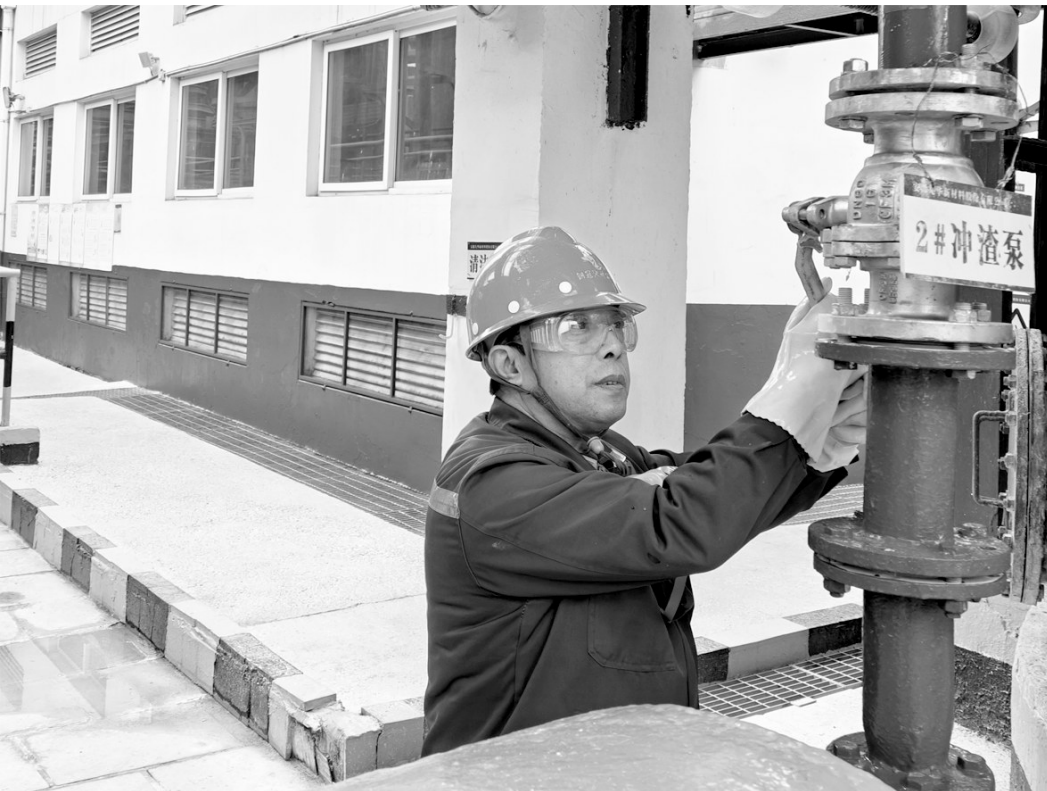
图为彭启东正在控制压滤冲渣泵流量大小。
