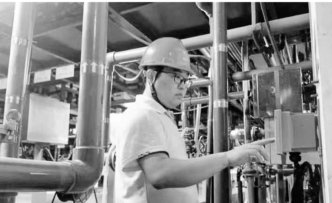
图为王琦正在调试pH自动添加系统。
