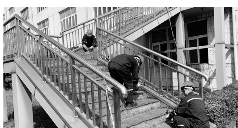
日前，在金隆铜业公司电解车间区域，相关人员正在对进入生产现场的梯梯进行防腐维护(如图)。该公司在企业安全生产过程中，对细节管理精益求精，全方位消除安全隐患，确保安全第一。章庆 摄
