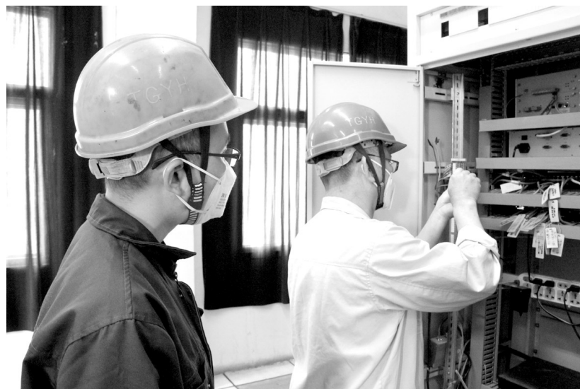
4月27日,铜冠冶化分公司两名电气技术人员正在检查110千伏变电所用配电箱。自3月份以来,该公司广泛发动员工围绕影响效益提升的关键点、关键工序、关键岗位深入开展合理化建议征集活动,为企业提质增效寻找“金点子”。其中,高低压配电室增加环境监测系统项目在生产中得以实施,创效近16万元。 钱庆国 摄
