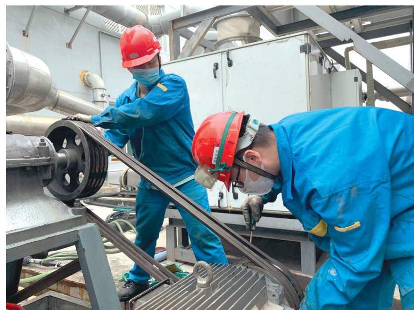
日前,铜陵铜箔公司开展停产检修工作。此次检修将完成溶铜工段六个系列停机维护,110千伏变电站停电检修、外循环塔清洗等40多项工作任务,为后期设备安全高效运行,进一步提高生产效率提供保障。图为检修人员正在进行设备调试。
