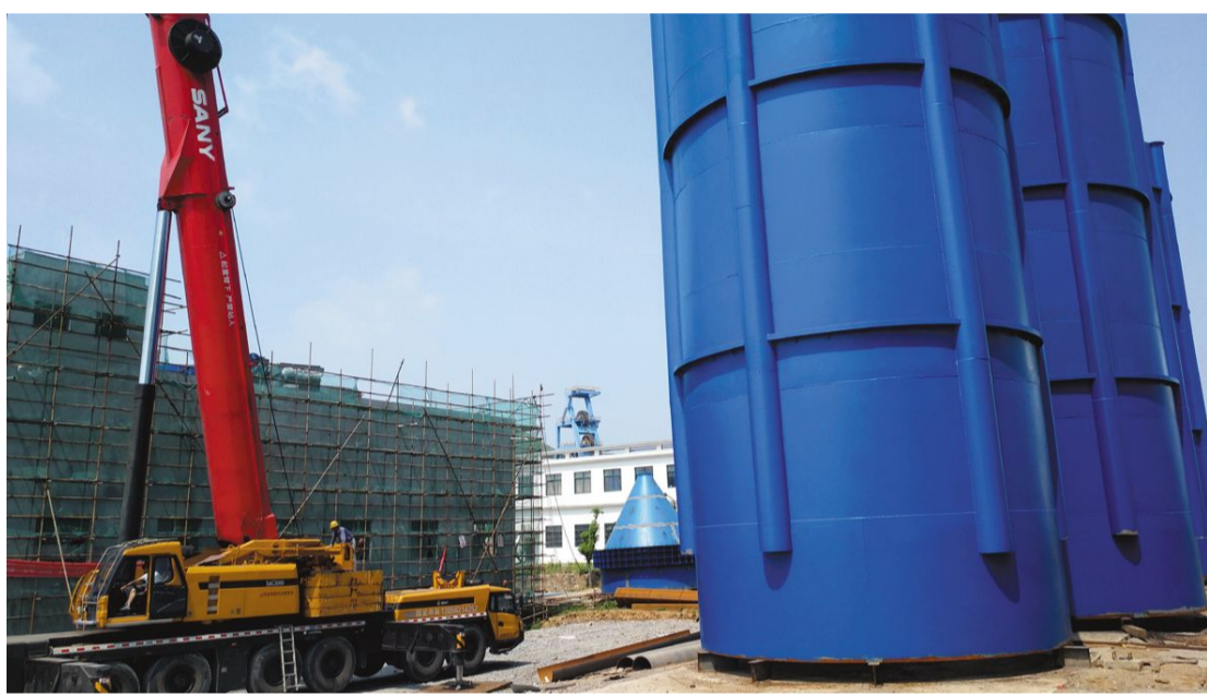
6月1日上午,铜冠(庐江)矿业公司充填系统地表充填站充填料仓一次性吊装就位(如图),标志着该系统建设即将转入设备安装阶段。 潘小祥 摄
