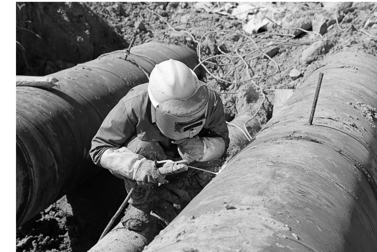
铜冠建安安装公司职工日前正在沙漠项目中焊接管道。铜冠建安安装公司发挥安装施工的技术优势,在沙漠项目建设中不仅承担了大型设备的安装,还积极承担了辅助项目选矿生产供水和回水管道的安装。自8月份开始管道安装施工以来,1000多米的管道目前已完成了三分之二,预计年底完工交付使用。
