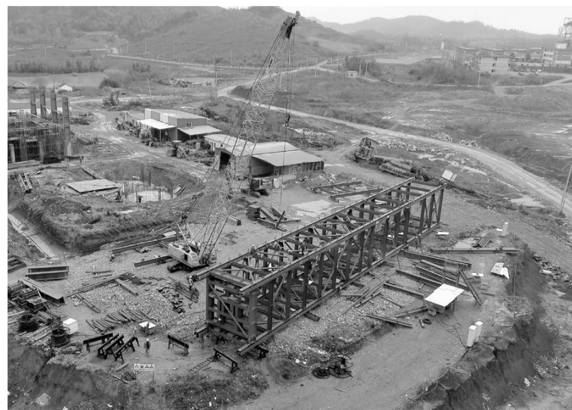
安徽铜冠(庐江)矿业有限公司沙溪铜矿年330万吨采选工程主井井架工程已进行现场安装阶段。该工程于3月22日开始进行第一根钢排架的拼装,现正进行套架的拼装。目前,沙溪主井井架套架已现雏形,已完成套架总量的80%,全部套架计划在4月15日拼装完成。谢玉玲 摄
