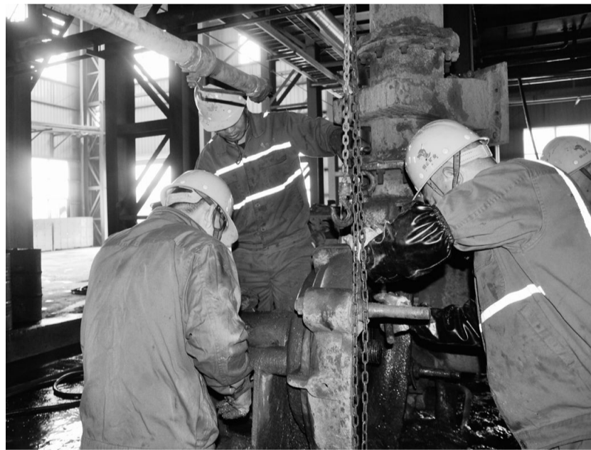
铜山矿业公司以实际行动在生产过程中推行“短、平、快”管理,全面实施“小修立即、大修连续干”措施,确保生产各环节畅通无阻。图为该公司选矿车间抢修砂泵时的情景。夏富青 摄
