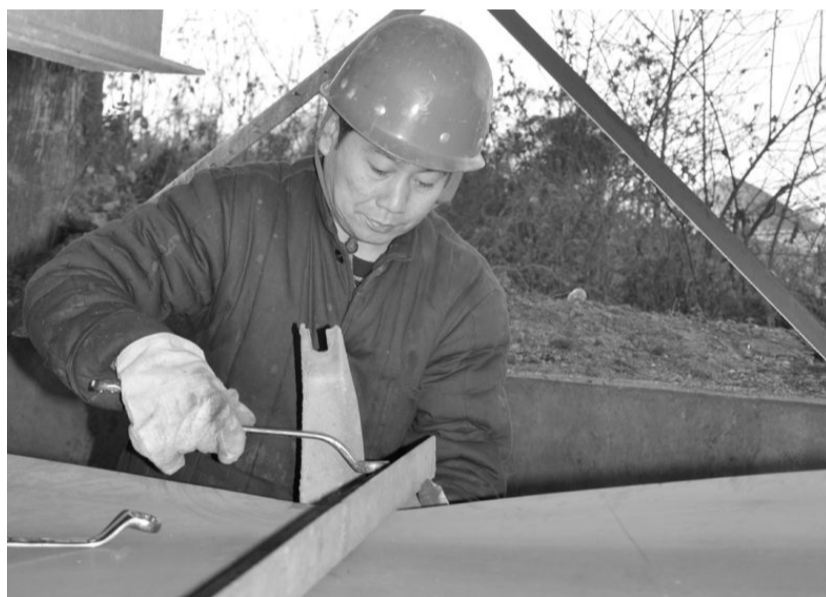
为确保安全生产,铜山矿业公司对各类生产设备做到不定期检查,发现问题及时整改,确保安全隐患无藏身之处。图为该公司码头分公司员工对皮带生产线进行检查维修。
