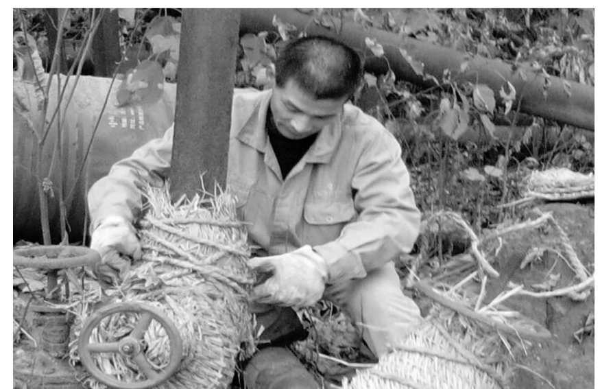
日前,天马山矿业公司金口岭选矿车间针对陶瓷过滤设备在低温时会冻裂损坏的情况,及时对清洗过的陶瓷板进行覆盖防止冻裂,同时对车间区域暴露在外的管道和阀门进行包扎,为它们穿上“保暖衣”,确保机械设备安全过冬,保证冬季的生产安全运行。 朱艳 张叶 摄
