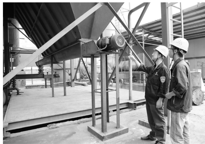
日前,铜冠投资神虹化工公司管理人员正在巡查新上除尘系统运行状况。神虹化工公司针对转炉技改后,因产能增加而导致除尘量同步增长,原有除尘系统不能满足环保处理的实际,今年投入资金及时新增了一套除尘系统,保障了当前新产能下实现环保生产的需要。
