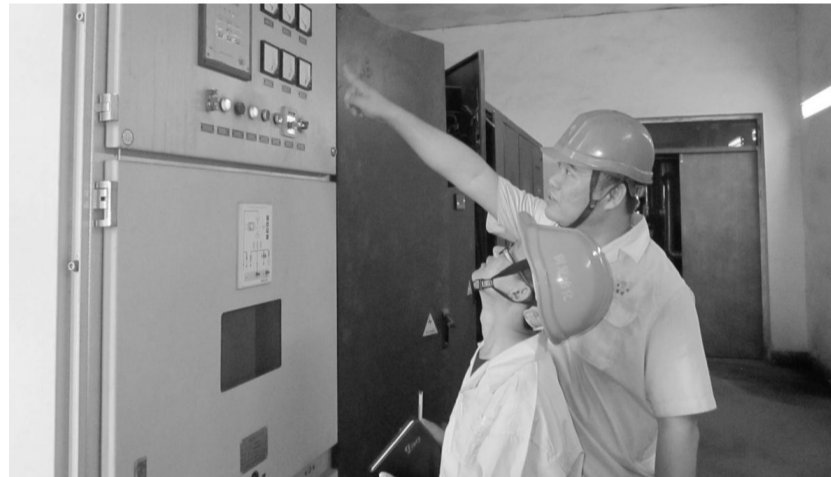
在“安全环保,意识先行”活动中,铜冠冶化分公司动力车间注重充分发挥青年安全监管岗的作用,安全员和青安岗成员每天深入作业现场,排查安全隐患,确保设备安全持续运行。图为安全员和青安岗成员在检查设备情况。 朱长华 宋新勇 摄
