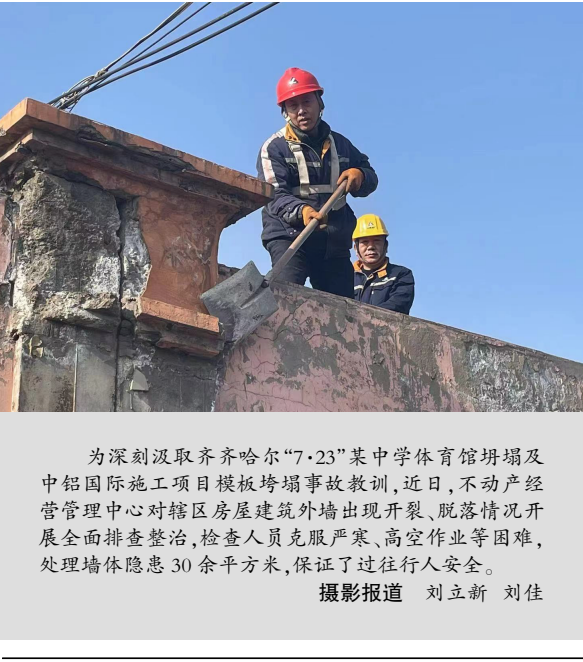
为深刻汲取齐齐哈尔“7·23”某中学体育馆坍塌及中铝国际施工项目模板垮塌事故教训,近日,不动产经营管理中心对辖区房屋建筑外墙出现开裂、脱落情况开展全面排查整治,检查人员克服严寒、高空作业等困难,处理墙体隐患 30 余平方米,保证了过往行人安全。
