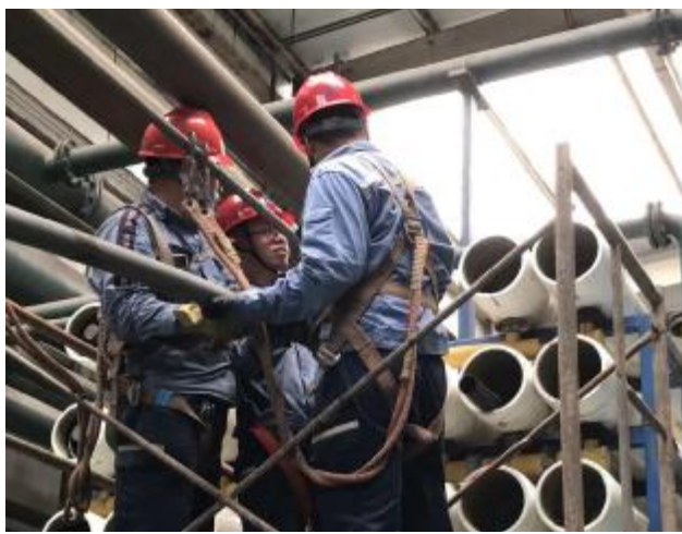
为提高水处理设备运行效率,降低设备更新维护成本,近日,热电厂燃化区党支部组织党员突击队,对6号反渗透膜元件进行自主更换。更换过程中,党员骨干克服天气热、设备拆卸难、工作环境有限等不利因素,经过8个小时的努力,共更换膜元件132支。图为党员突击队正在更换膜元件。摄影报道 崔丽娜
