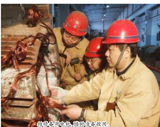
维修备用电机,随时准备投用。
