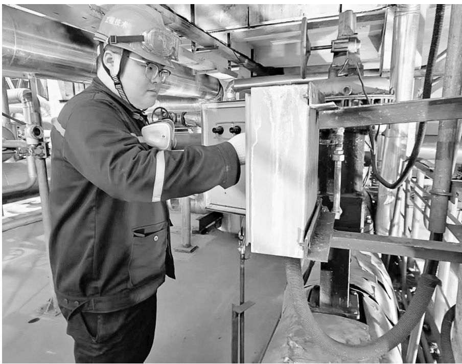
图为朱军在铜冠冶化动力车间脱盐水处理站控制箱进行检查调试。
