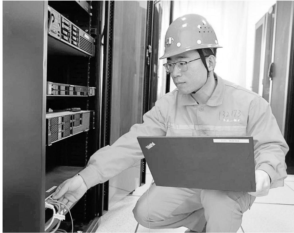
图为董心正在机房检查地震监测系统运行情况。
