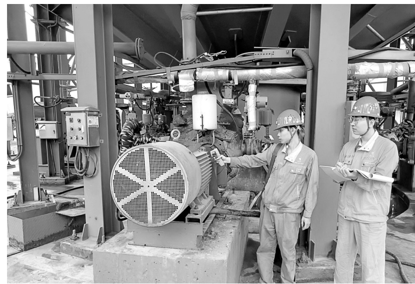
近日,铜冠(庐江)矿业公司选矿车间组织开展夏季电气设备专项巡检,重点排查高温下设备过热、接点氧化等安全风险。图为两名点检人员对新深锥5号泵电机测温并做好数据记录。
