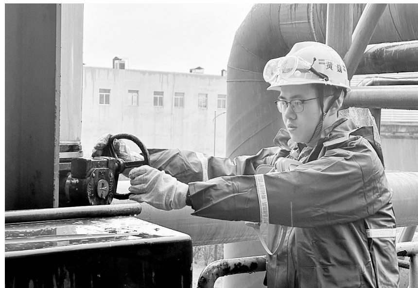
图为黄巍在净化电除雾器顶部开启冲洗水阀。
