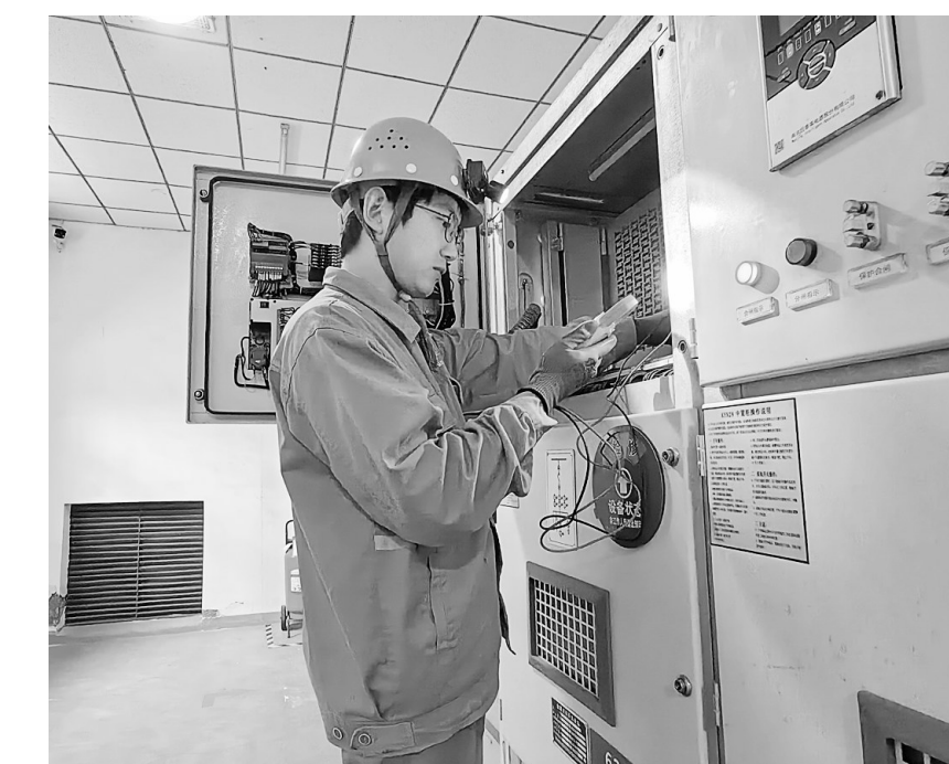
图为宋京京在点检高压开关柜。
