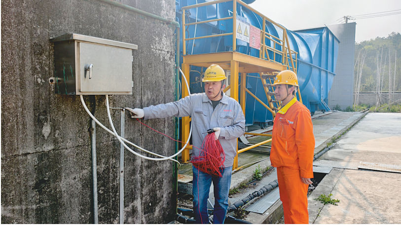
日前,铜冠(庐江)矿业公司严格按照防雷电相关规范标准,委托专业检测机构开展全方位防雷电检测,检测范围覆盖主副井塔、配电室、南北风井、通信机房等重点场所。图为工作人员正在对南风井供电设备进行检测。通讯员 黄从斌 季广祥 摄
