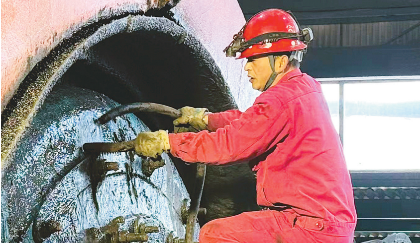
近日,天马矿业公司选矿车间检修工人利用停机检修的间隙,组织人员对球磨机表面的油污、矿泥进行细致清理。该公司此举不仅改善了作业环境,消除了安全隐患,更彰显了员工主动践行5S管理理念的责任意识,营造出“人人讲规范,处处见标准”的良好氛围。 通讯员 夏王浩 摄
