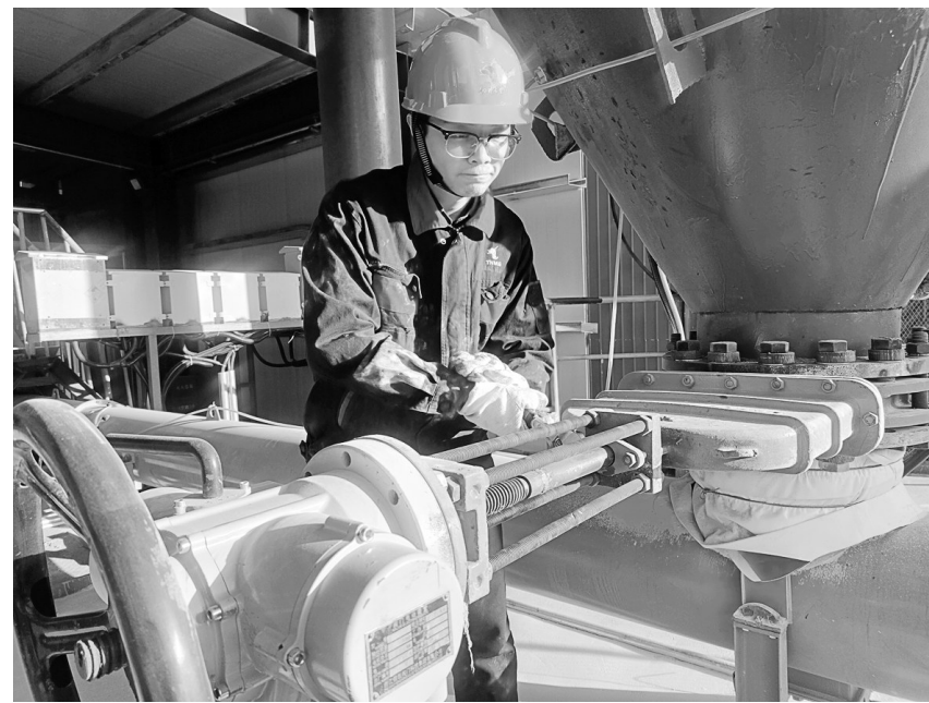
图为周子骏在山西紫金项目部现场检修原料仓电动插板阀。
