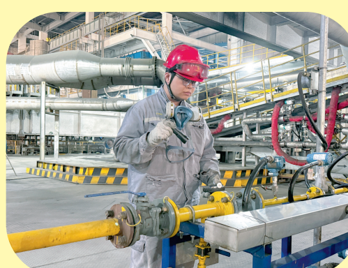
► 图为汪凌松对熔炼二号烧嘴阀组进行点检并进行天然气泄漏检测。
