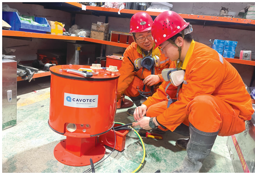
铜冠(庐江)矿业公司采矿工区一直坚持实施设备预防性维护,通过定期检测、分析设备运行状态,及时发现并处理潜在故障,降低设备故障率。图为近日该工区维修人员对电动铲运机滑环箱进行检查维保。通讯员 陈资南 黄从斌
