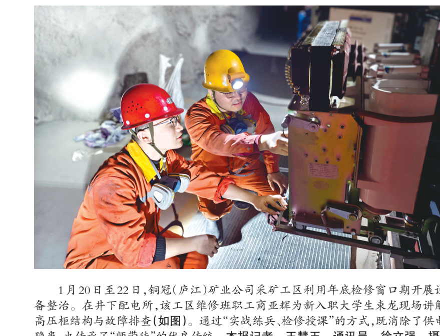
1月20日至22日,铜冠(庐江)矿业公司采矿工区利用年底检修窗口期开展设备整治。在井下配电所,该工区维修班职工商亚辉为新入职大学生束龙现场讲解高压柜结构与故障排查(如图)。通过“实战练兵、检修授课”的方式,既消除了安全隐患,也传承了“师带徒”的优良传统。本报记者 王慧玉 通讯员 徐文强
