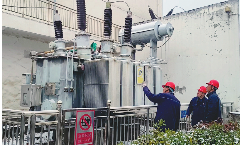
日前,铜山铜矿分公司及时落实应对极端寒冷天气的各类应急措施,组织人员对室外重要区域设备、供电线路、管道进行巡视检查,以确保设备安全稳定运行,为首季生产“开门红”提供坚实保障。图为该公司电力专业人员巡查矿山各条供电线路及设备。
