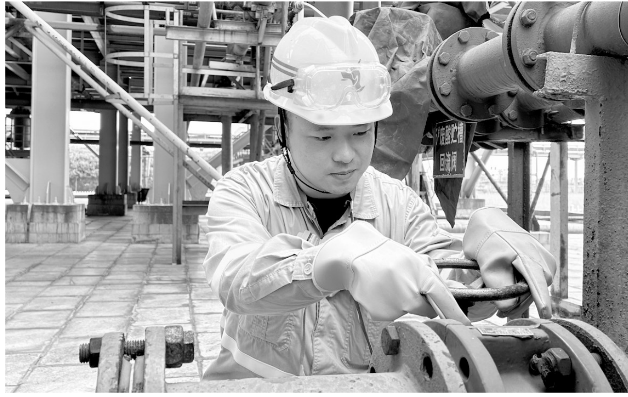
图为王贵隆在现场检查废酸贮槽备用泵阀门。
