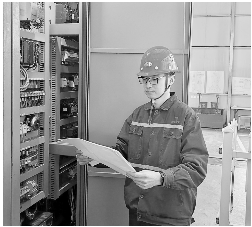
图为黄鹤鸣在山东朱郭李家工程项目上进行电控设备检查。
