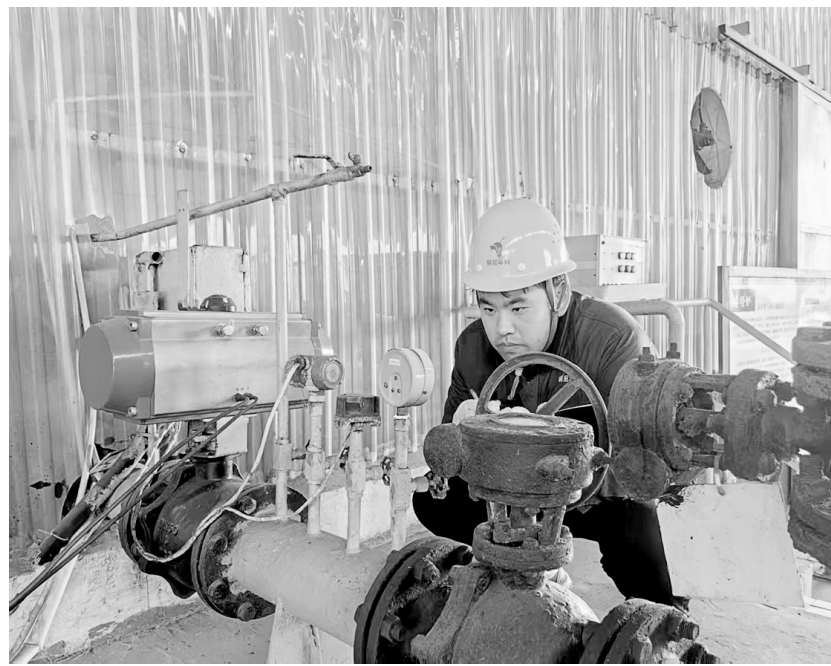
图为丛振在硫化钠车间记录燃烧器压力表数据。
