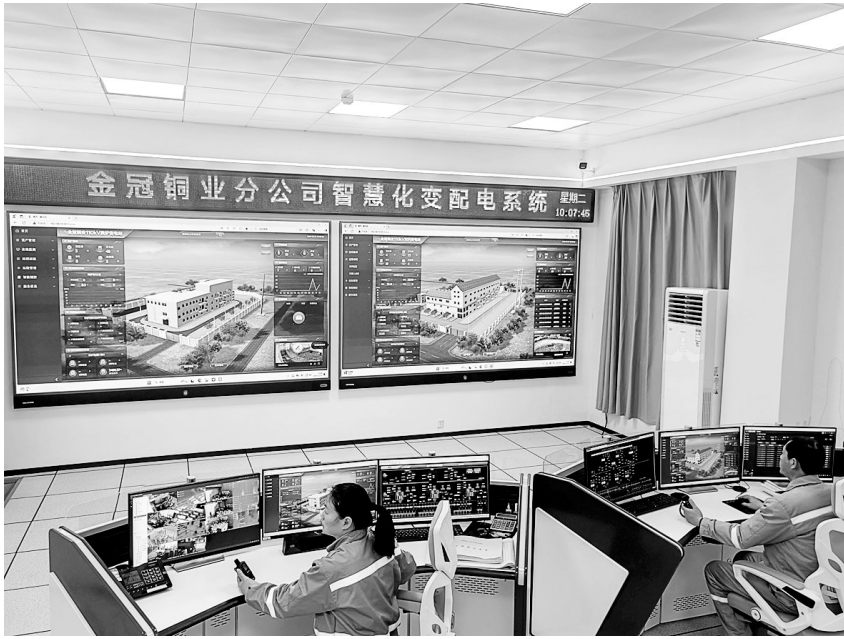
图为金冠铜业分公司建成投用的智慧化变配电系统中控室。
