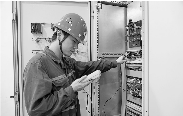
图为章健对混合井提升机电控柜进行日常巡检。
