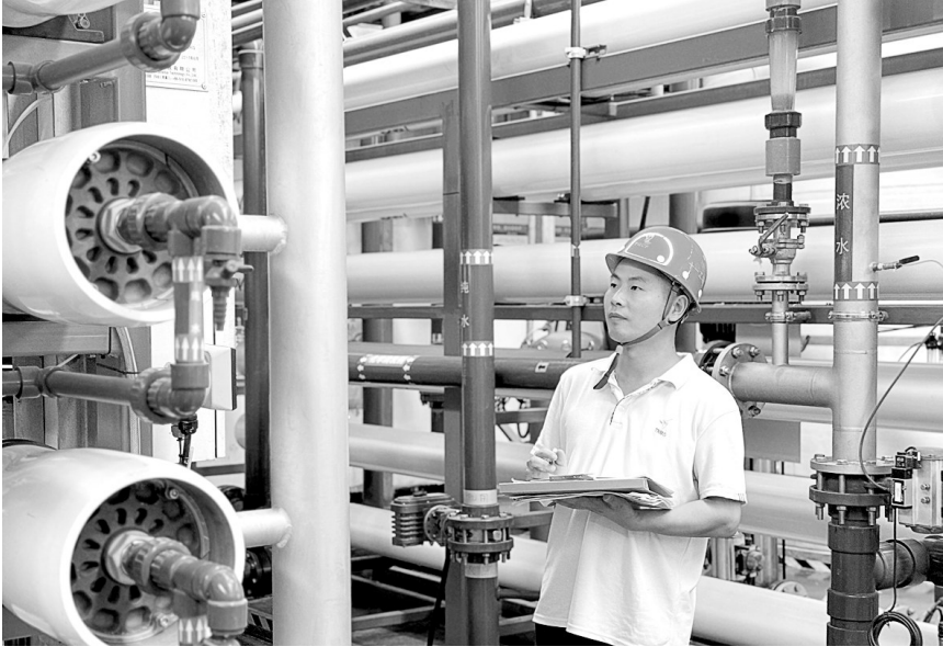
图为袁生强正在巡检设备运行状况。
