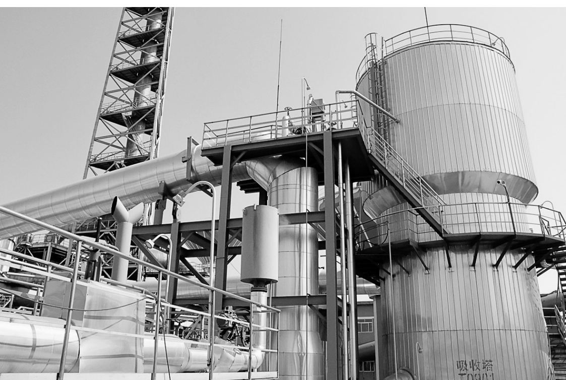
图为金隆铜业低温余热回收装置。
