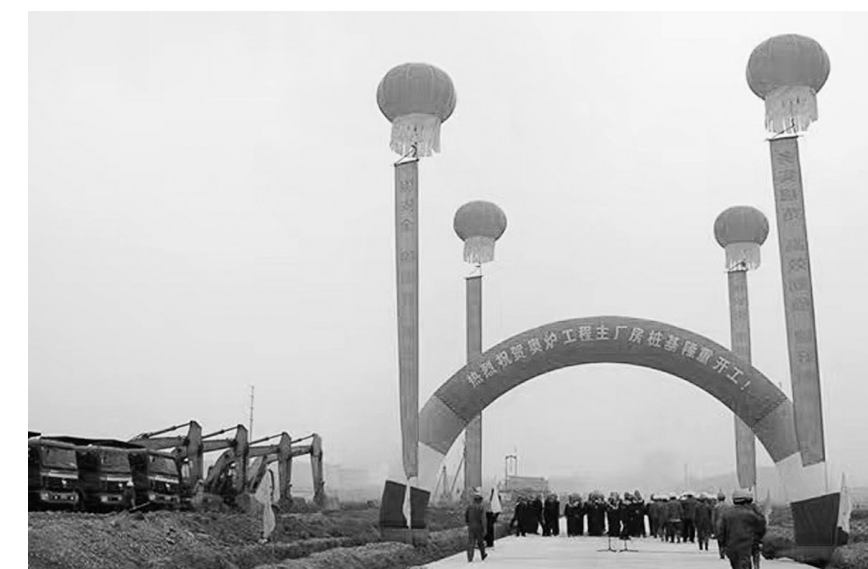
图为2016年3月18日,集团公司奥炉工程熔炼主厂房桩基工程开工。
