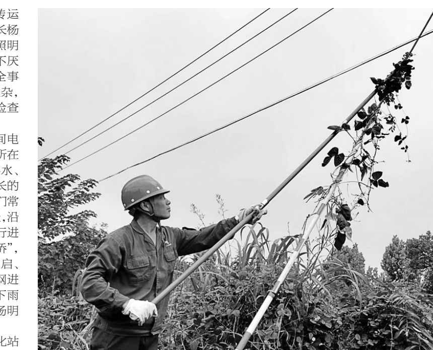
图为杨明在动力厂热电车间至滨江大道路段清除10KV架空线杆上缠绕的杂草。
