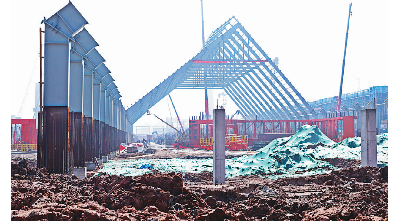
铜冠建安公司第一建筑工程事业部承建的铜基新材料项目精矿库工程日前正在紧张有序施工。春争日,夏争时。该事业部在承建的绿色智能铜基新材料项目精矿库工程中趁着春日好时光,组织精干力量,快马加鞭推进项目建设。本月底有望提前完成矿仓底板浇筑任务,为后续施工争取了宝贵时间。 本报记者 王红平 通讯员 陈卫娟 摄
