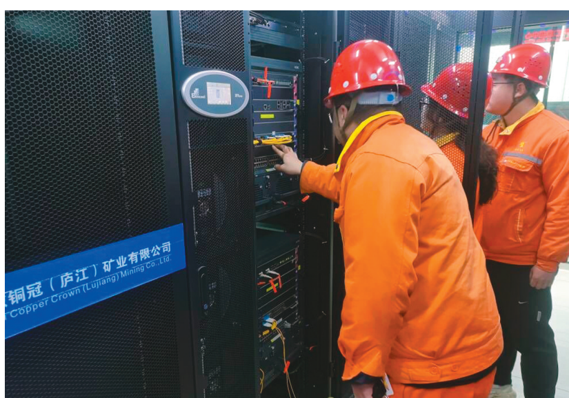
日前,铜冠(庐江)矿业公司职工正在机房实时全景监控矿区情况。多年来,铜冠(庐江)矿业公司推进5G工业网络区域覆盖和应用场景建设,通过5G智能交互项目,实现矿区重点区域超高清全景监控。
