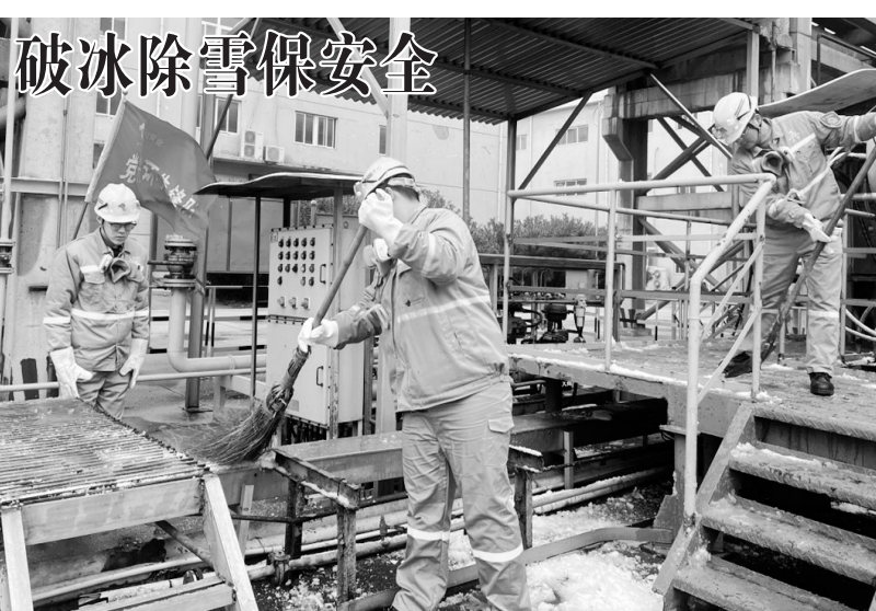
近日,金冠铜业分公司双闪硫酸车间积极组织党员安环先锋队成员赴生产现场各作业区域,对现场各区域平台、楼梯、主要道路积雪集中进行清理,消除安全隐患,方便员工现场作业行走,保障安全。 韩杜炎 摄
