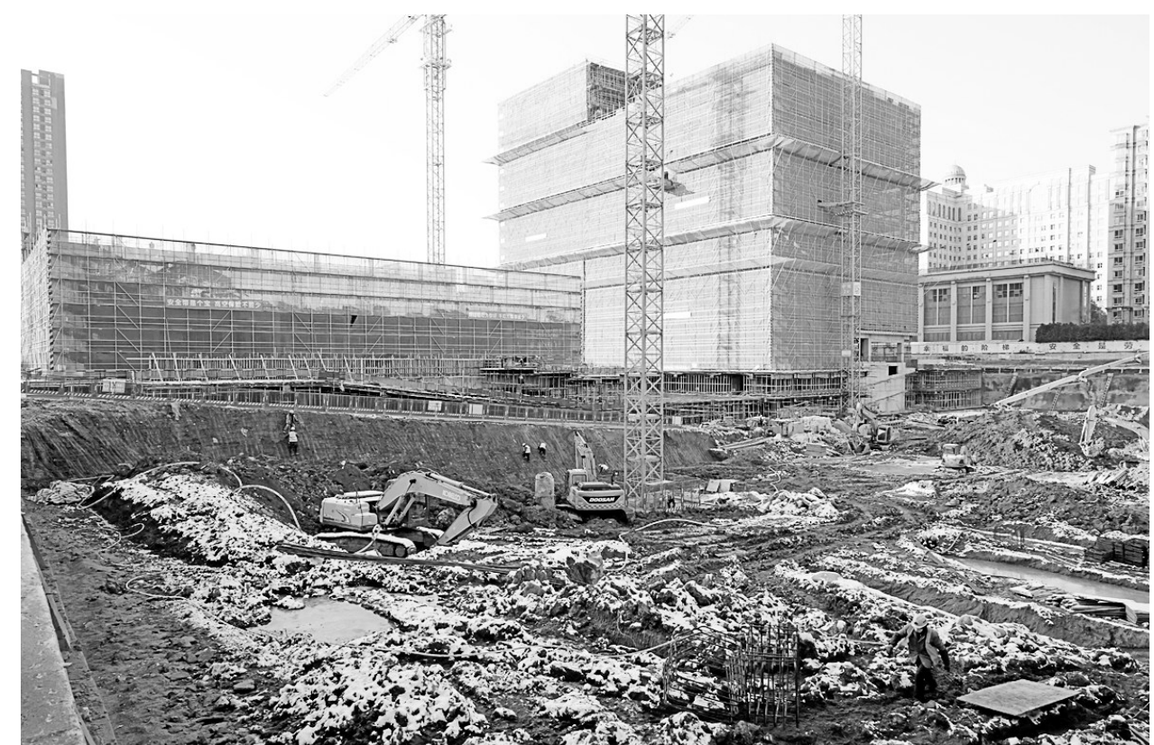
安徽铜冠房地产公司合肥铜冠广场项目日前取得进展。由安徽铜冠房地产公司在合肥经开区开发建设的铜冠广场,自今年3月份开工以来,工程按分批施工的计划稳步推进,并取得积极进展。目前,1号楼已完成14层结构施工,即将封顶;2号楼正在开展4层结构施工;3号楼和4号楼正在同时进行基础施工。4栋楼施工建设正全面展开。 王红平 邱豪 摄影报道
