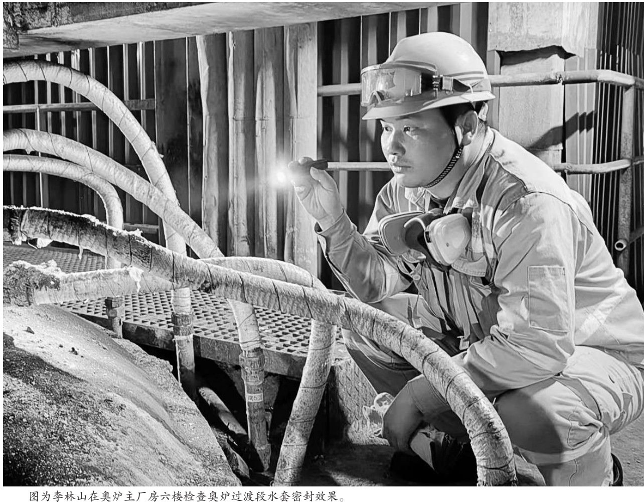
图为李林山在奥炉主厂房六楼检查奥炉过渡段水套密封效果。
