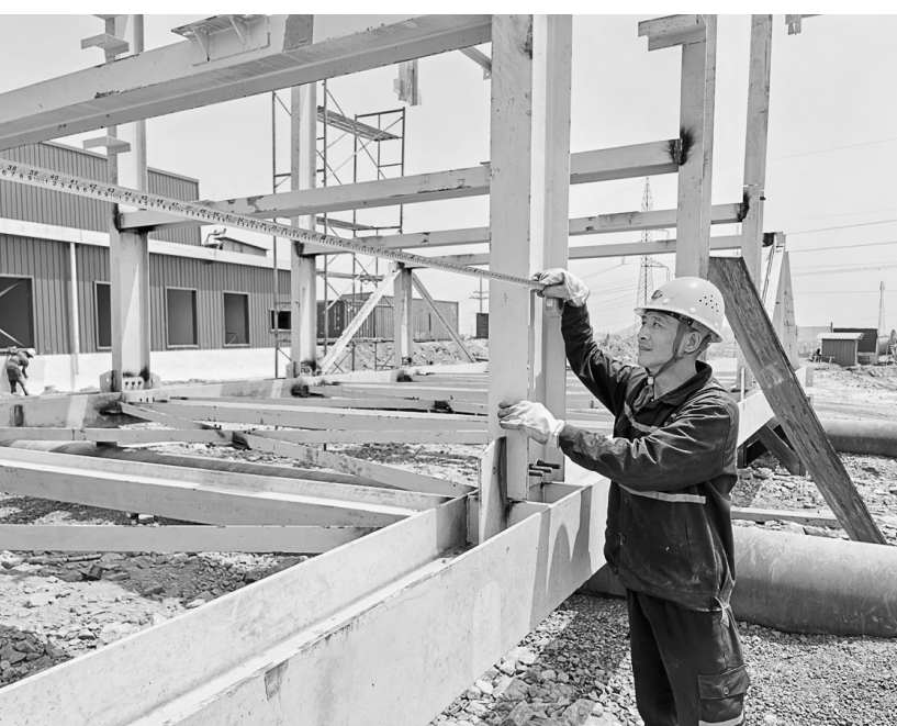
图为刘锋在刚果(金)卡莫亚项目现场进行井架立架尺寸测量。
