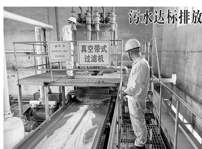
中秋、国庆长假期间,铜冠净化分公司综合车间污水处理站操作人员坚守岗位,加强工艺设备巡检,保障系统稳定运行,实现污水达标排放。图为过滤机操作人员现场巡检。
