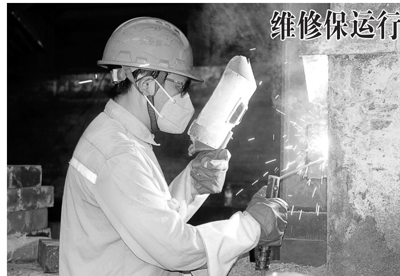
张家港铜业公司为确保设备稳定运行,提高生产效率,对1号阳极炉实施为期20天的中修。图为近日该公司动力车间人员进行炉门框水套安装。张万兴 摄
