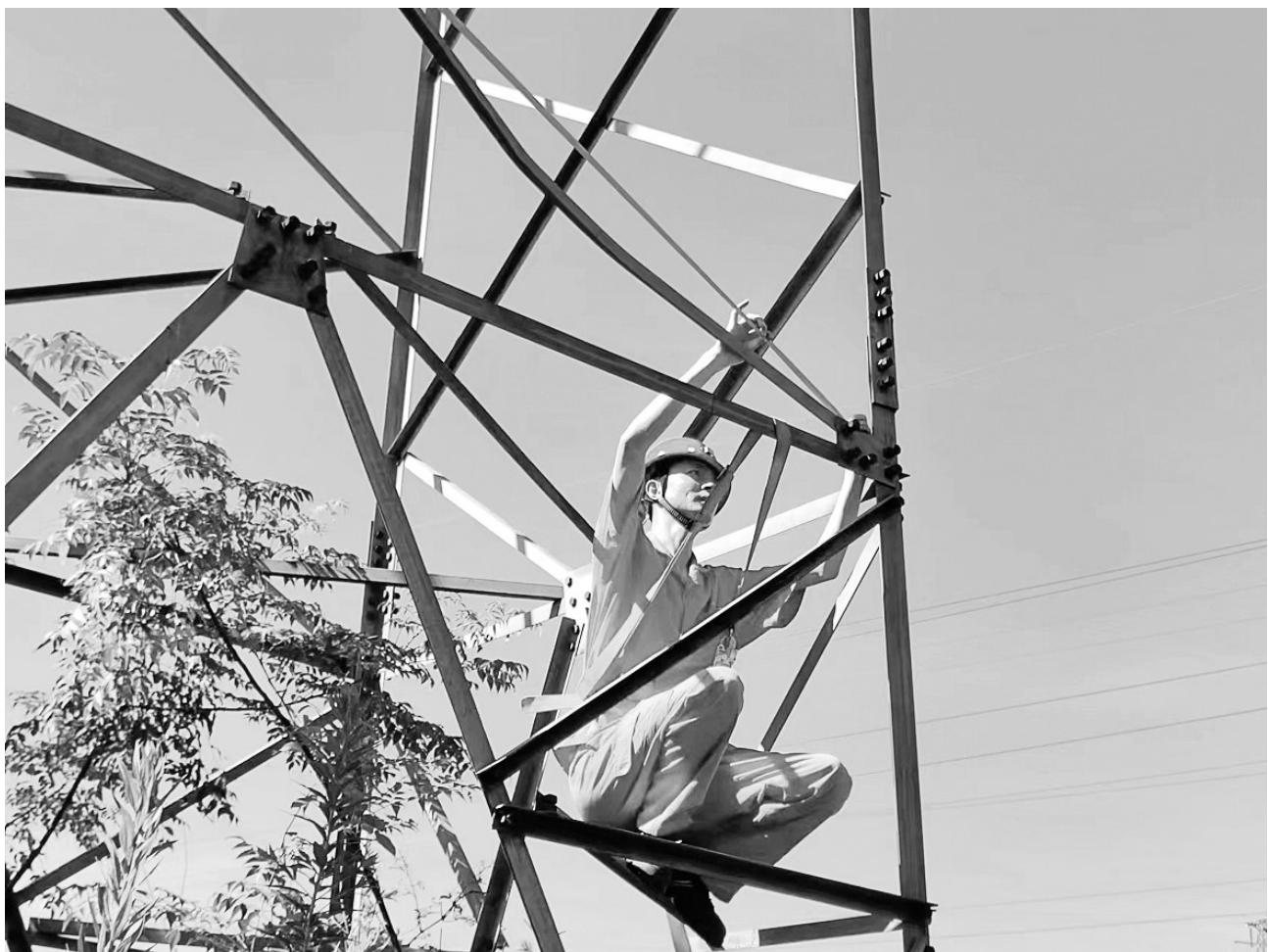
图为杨李军对110千伏458线路铁塔支撑角铁弯曲变形情况进行检查。
