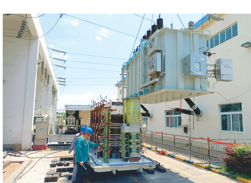
入夏以来,铜冠池州公司动力保全中心抢抓检修系统大修时间节点,对供电系统关键设备实施系统性维保,确保迎峰度夏期间电力安全稳定运行。图为近日维保人员在110千伏总降变电所2号主变进行吊罩检查。张军 赵永志 摄
