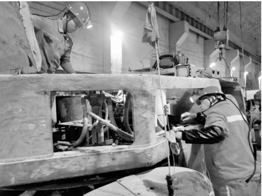
图为该公司采矿工区技术人员在负800中段维修硐室检查电机车。
