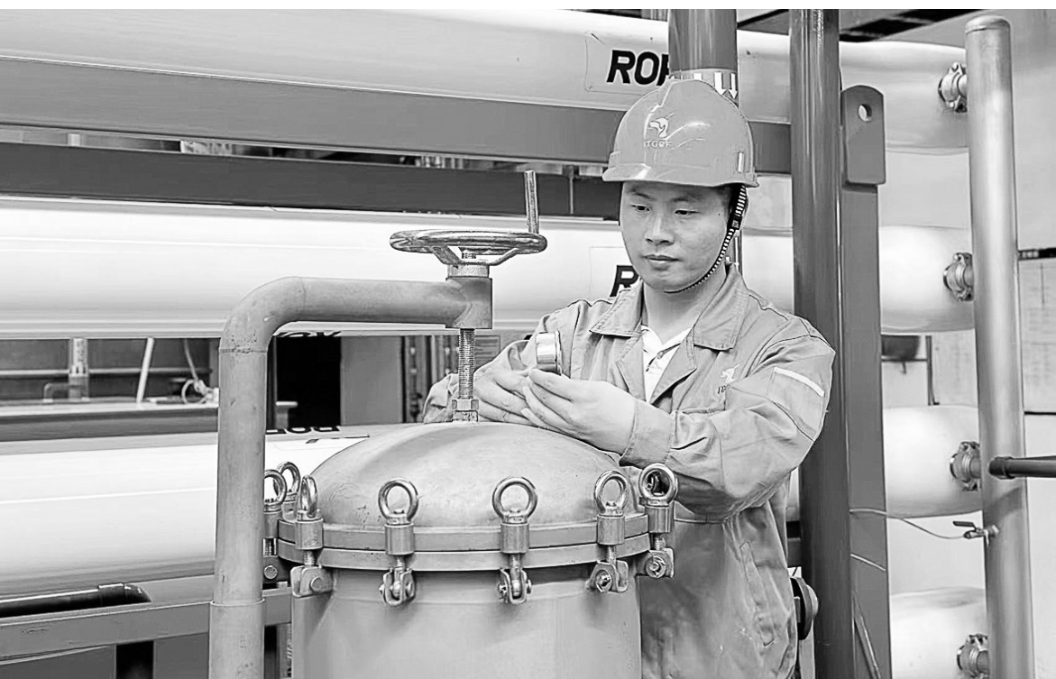
图为袁生强正在给反渗透设备保安过滤器进行排气。
