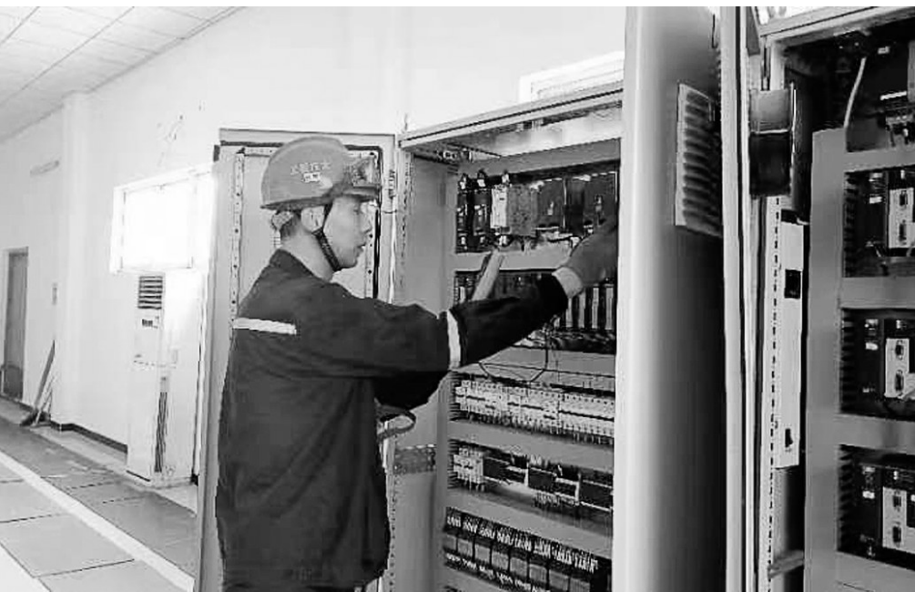
图为孔晔在金冠铜业双闪电解车间电解液循环自动化控制系统改造项目中安装调试。
