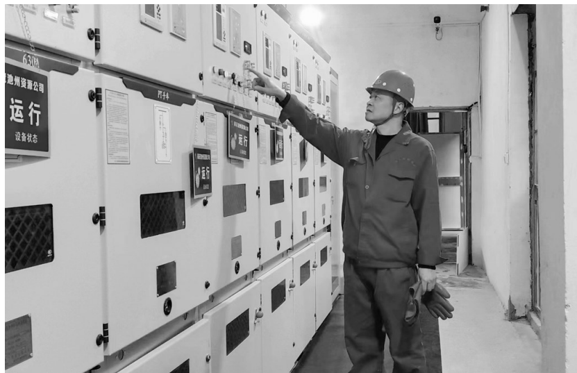
图为魏建在高压变电所维护检查运行情况。
