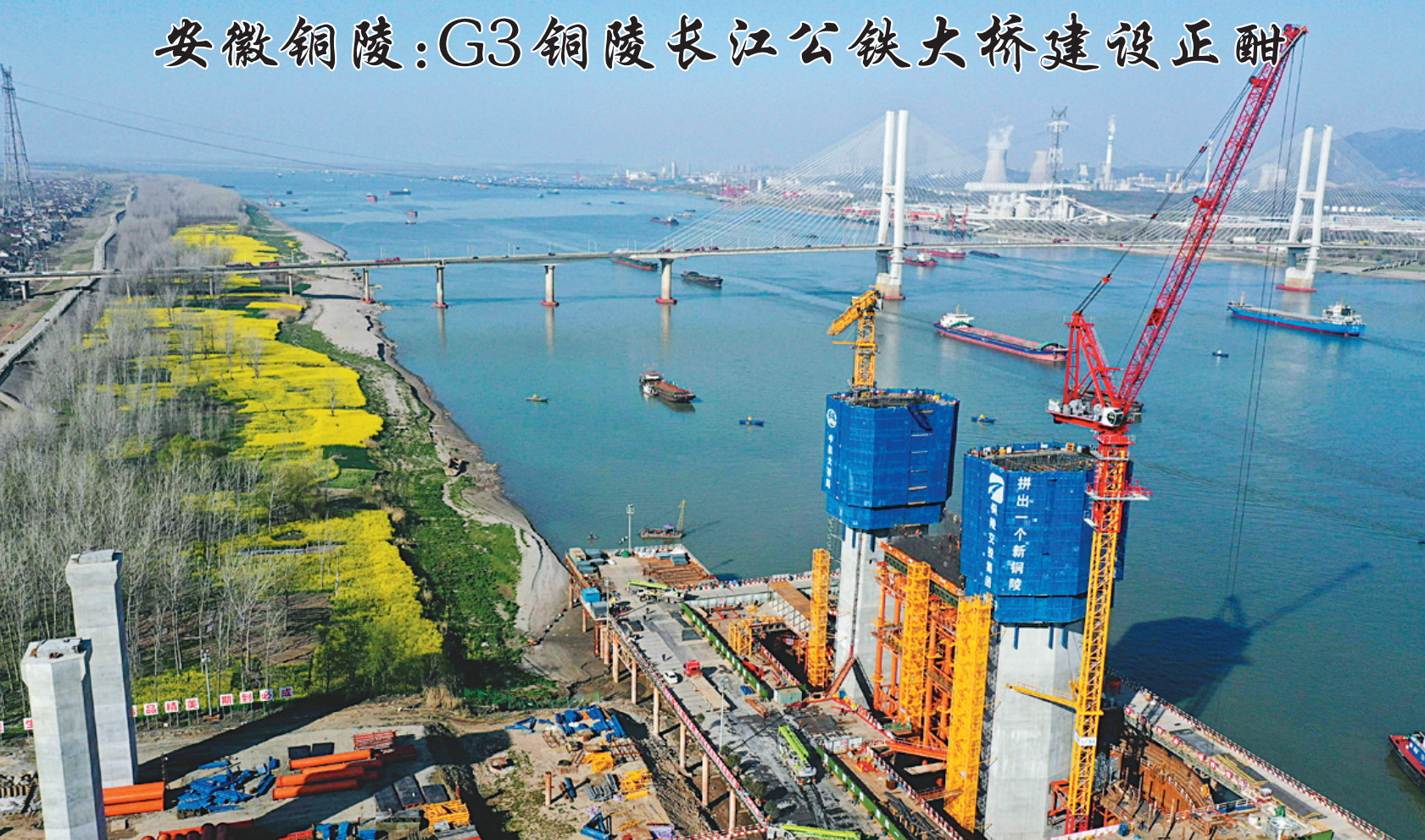
2023年3月13日,施工人员在G3铜陵长江公铁大桥进行3号主墩塔柱施工。G3铜陵长江公铁大桥为《长江干线过江通道布局规划(2020-2035年)》中规划的过江通道之一。大桥位于现有铜陵长江公路大桥上游约720米处,两端连接G3京台高速,既承担铜陵长江公路大桥替代桥功能,又搭载铁路过江,按照四线铁路、六车道公路标准建设。大桥建成后将对区域经济社会协调发展、长三角互联互通等产生积极作用。 人民网
