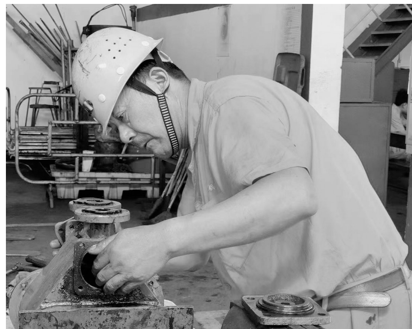
图为陶奎正在修复鼓风机油站滤芯阀门。
